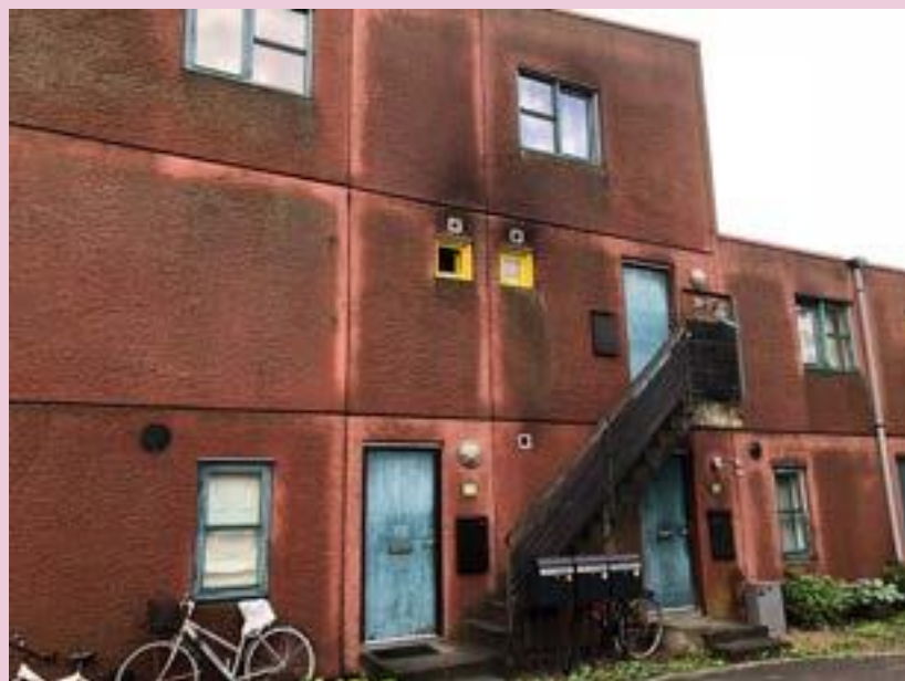
Tydelige kuldebroer (før renoveringen) der giver grobund for skimmel i boligerne
